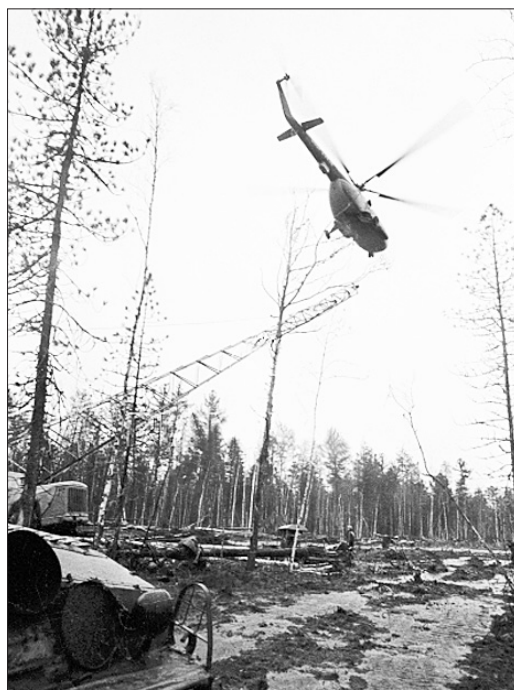
● Транспортировка опоры линии электропередачи на Ми-8. Возможно, за штурвалом этого вертолета был именно Юрий Редькин.
